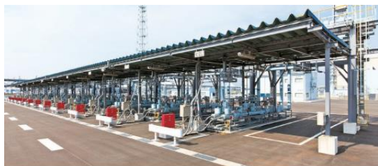
ひびきLNG基地 出荷設備
