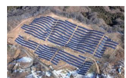
S-11 CS皆野町発電所
