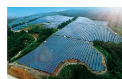
S-13 CS益城町発電所
